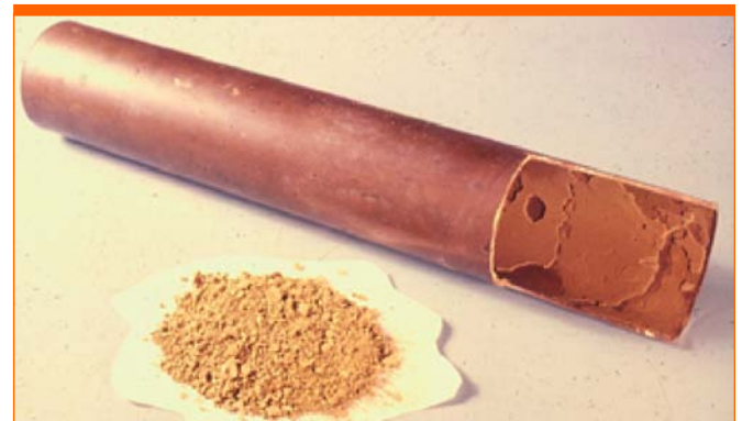
Figura 1 – Depósitos producto de la descomposición del aceite en las paredes internas de las tuberías del sistema
