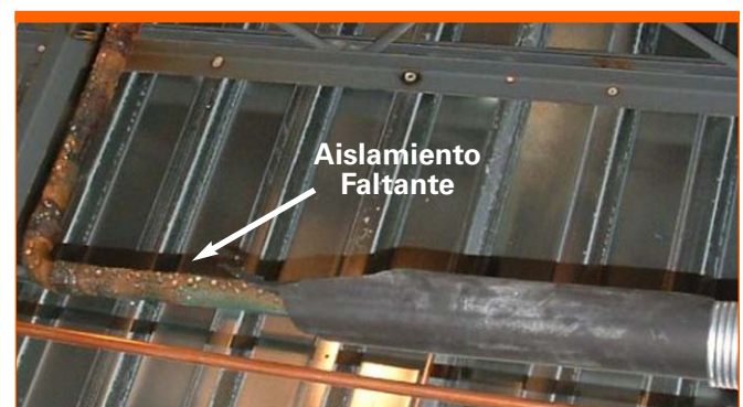
Figura 10 – Aislamiento Faltante en Línea de Succión
